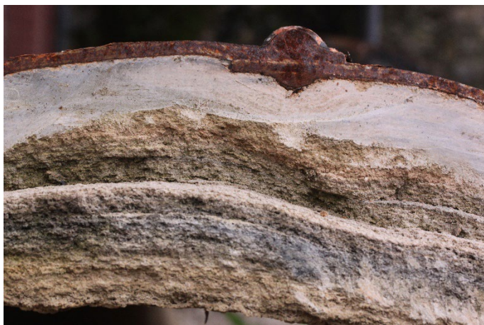
Vue d'une conduite forcée de la turbine hydroélectrique d'Arbois. Le tuf s'est accumulé à l'arrivée de la conduite dans la turbine sur une épaisseur de 1 à 2 cm. ©P. Collin
